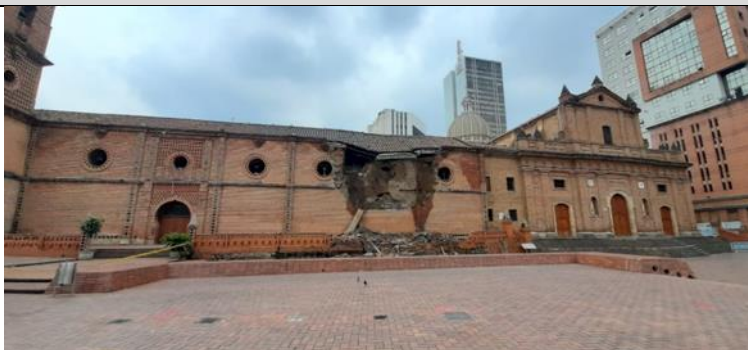
Colapso fachada sur capilla La inmaculada
